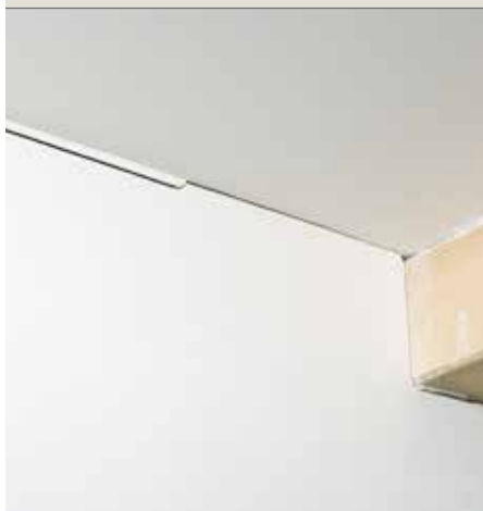
Nevienmērīga plaisa neatdalītu konstrukciju dēļ.
